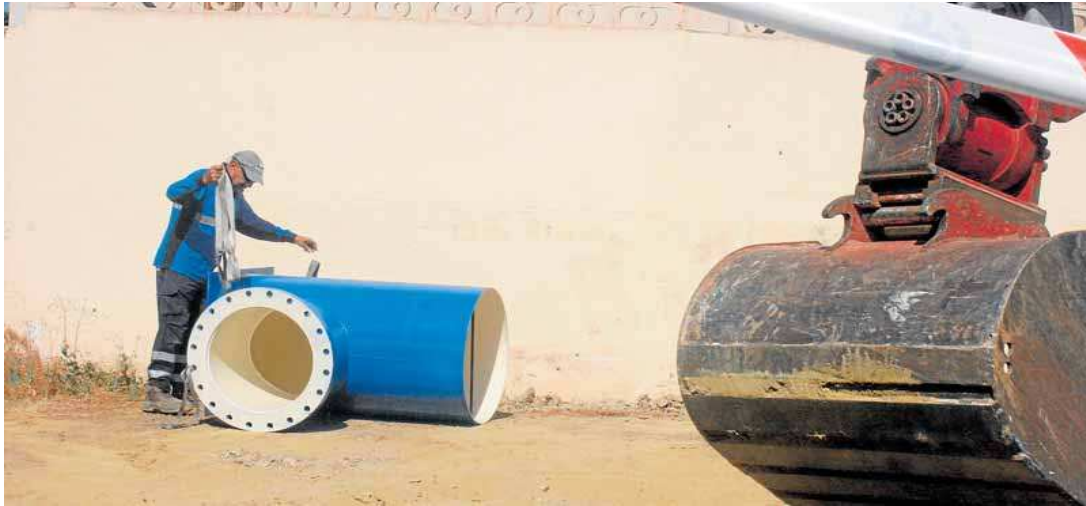
Acosol inició el lunes la actuación de emergencia para inhabilitar el tramo de la red de alta en la zona del hotel Los Patos. J. C. GARCÍA
